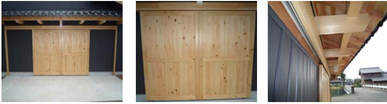
A学園同窓会館 改築工事(瑞浪市 商業施設) H23.11 木製建具工事
